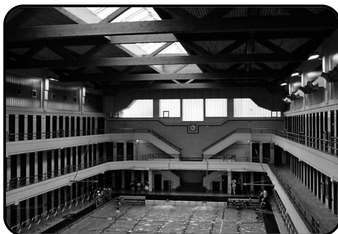
La rénovation de la piscine a été réalisée pour son centième anniversaire en 2005.
