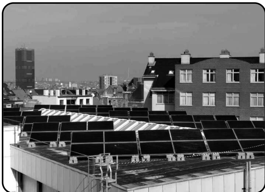
La piscine Victor Boin à Saint-Gilles : 180m 2 de capteurs solaires et une réserve de 5000 litres d'eau permettent de réduire les besoins en eau chaude sanitaire.
