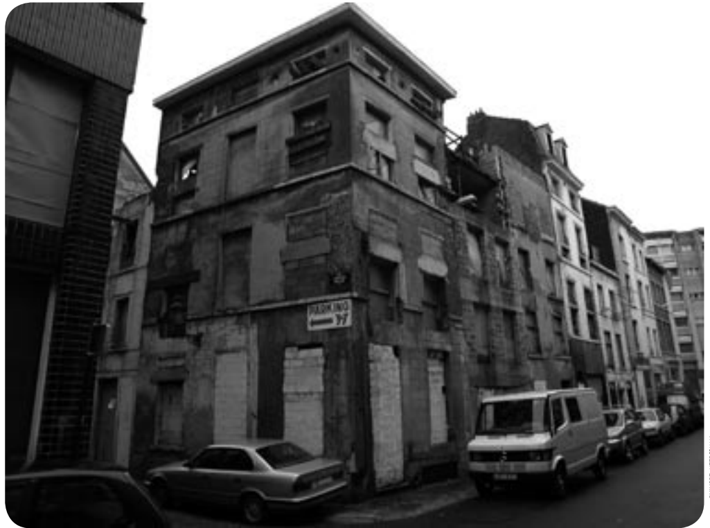
Trop de bâtiments vétustes et mal entretenus.
